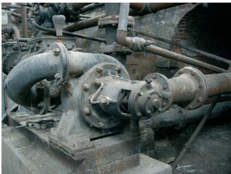
Monument historique : Pompe centrifuge électrique filature des Aulnes
