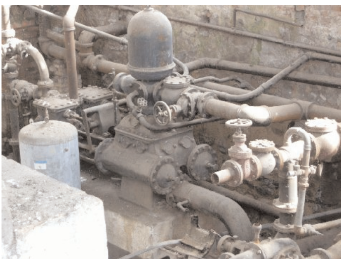
Fraize, pompe à vapeur fabriquée par Mather & Platt. Etat 2014.
